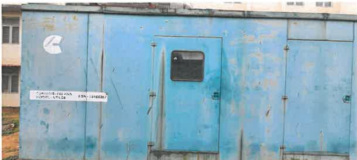
500 KVA DG Set
