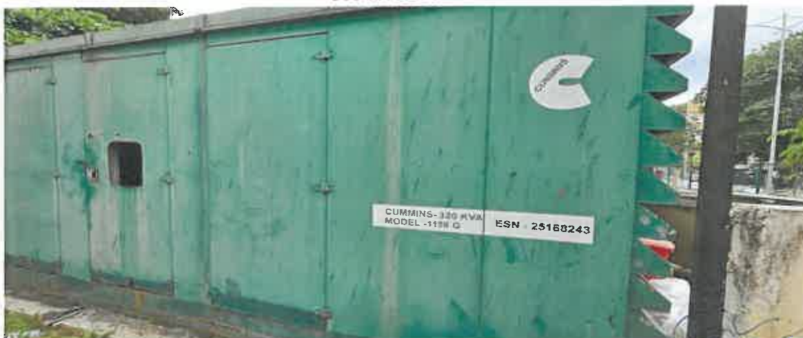
320 KVA DG Set
