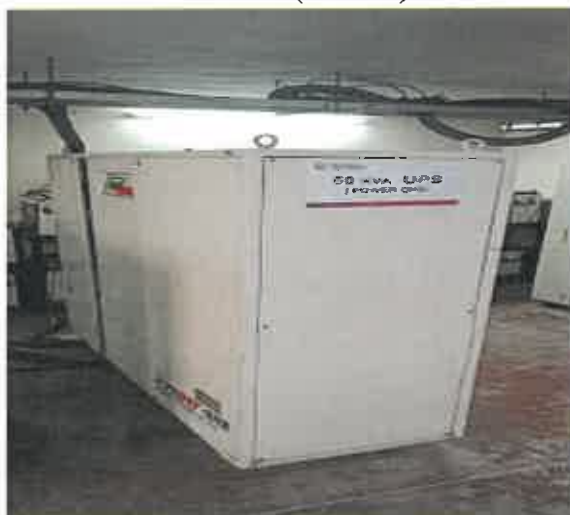
60 KVA UPS (A Block)
