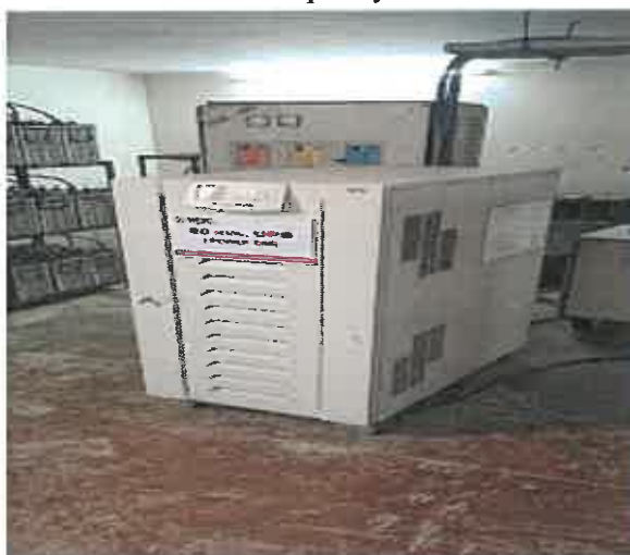
80 KVA UPS (A Block)
