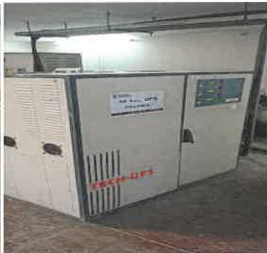
40 KVA UPS (A Block)
